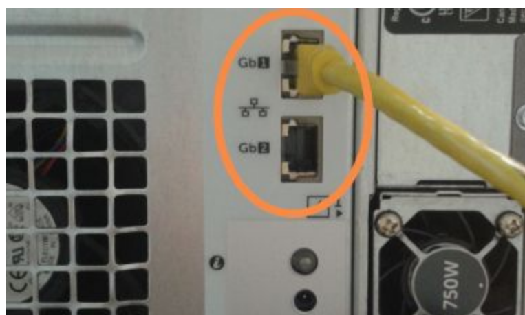
Figure 16-5: Ports Ethernet utilisés pour LIS
