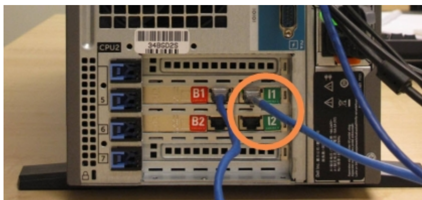
Figure 16-3: Ports du module de traitement du contrôleur
